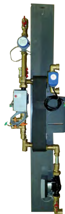
Estación solar de 15 a 30m²
